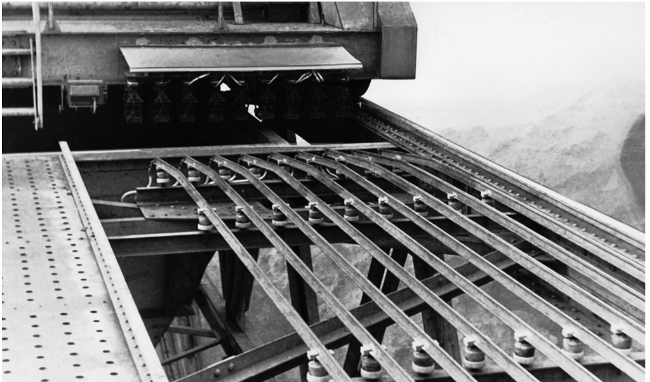
Brückendrehkran – Vahleschienen zu Auflaufkufen abgebogen
